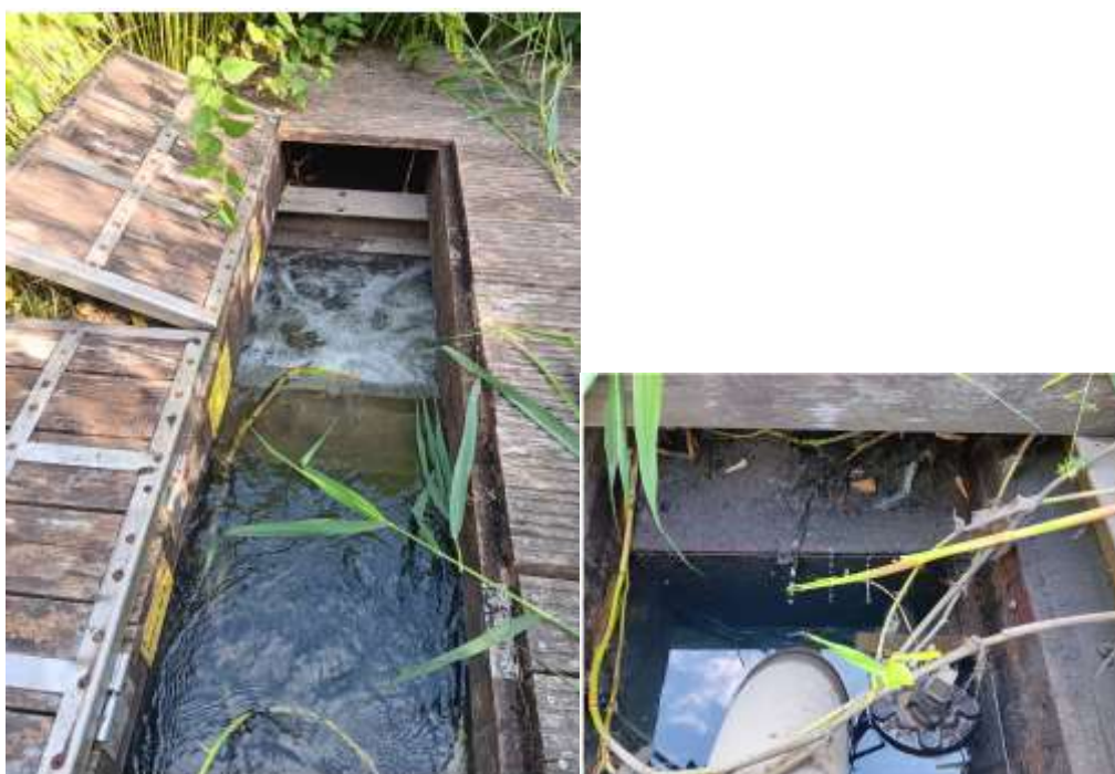
Figure 18: Déversement d'eau du filtre Fr vers le filtre F en raison d'un dépôt (sédiments végétaux) obstruant la sortie du regard de tranquillisation (13/06/2024). A gauche on aperçoit un bouillonnement de l'eau dans le regard du filtre S alors que c'est le R qui est alimenté.
