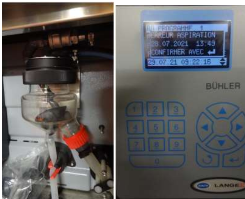
Figure 22: Dysfonctionnement du cycle de prélèvement d'un des préleveurs de la station de pompage en raison de l'obstruction du bol de prélèvement par un ballon de baudruche (29/07/2021).
