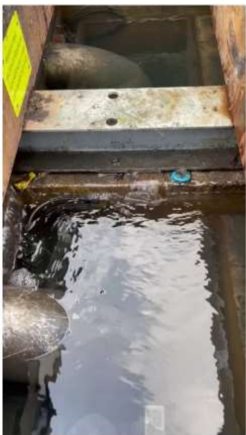
Figure 15: Débordement du filtre FR vers le filtre FS au niveau des regards de tranquillisation à l'arrivée des conduites de refoulement en amont des filtres ((septembre 2021).
