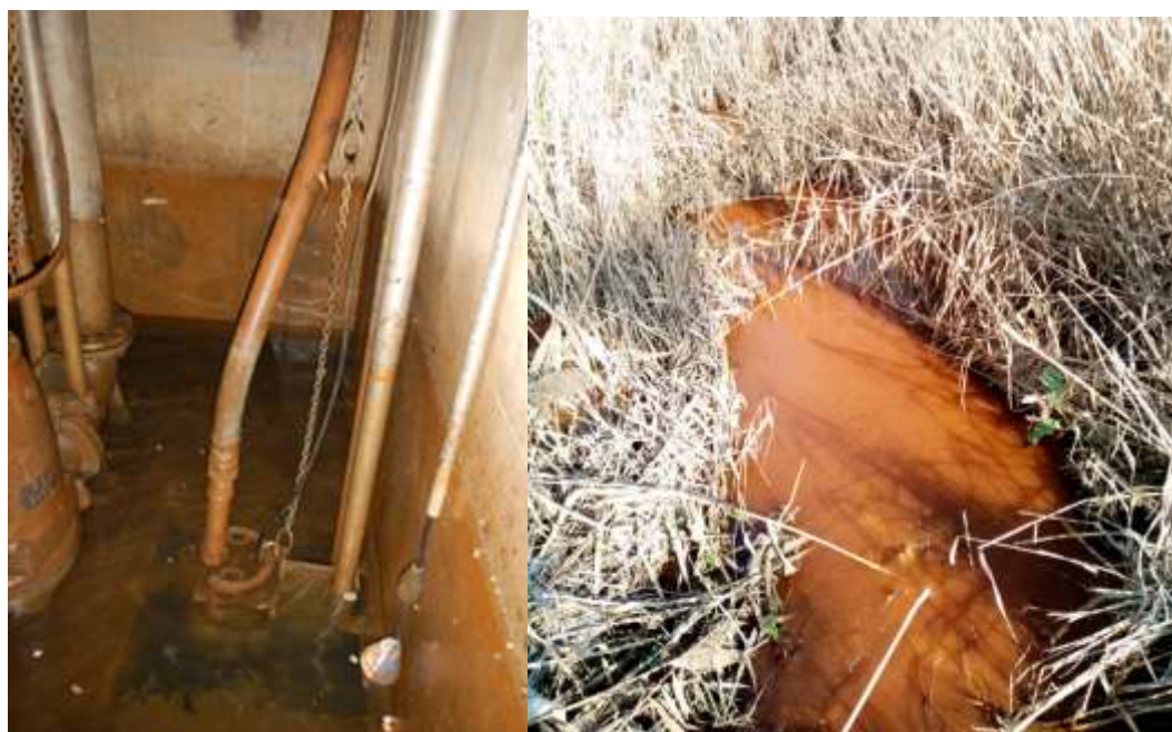
Figure 21: A gauche : Présence de dépôts riches en oxyde de fer dans la bache de pompage vers le filtre en fin de bâchée (Octobre 2020). A droite : arrivée importante d'oxydes de fer dans le filtre FS (30/02/2023).
