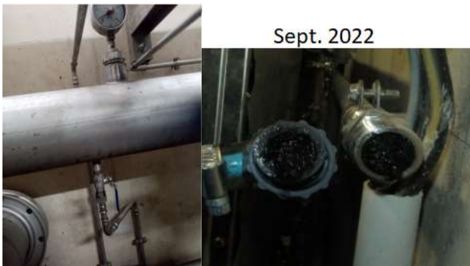
Figure 24: A gauche : Prise sous pression dans la conduite de refoulement pour alimenter les préleveurs dans la bache de pompe. A droite : Alimentation des préleveurs dans la bache de pompage obstruée par des dépôts noirs
